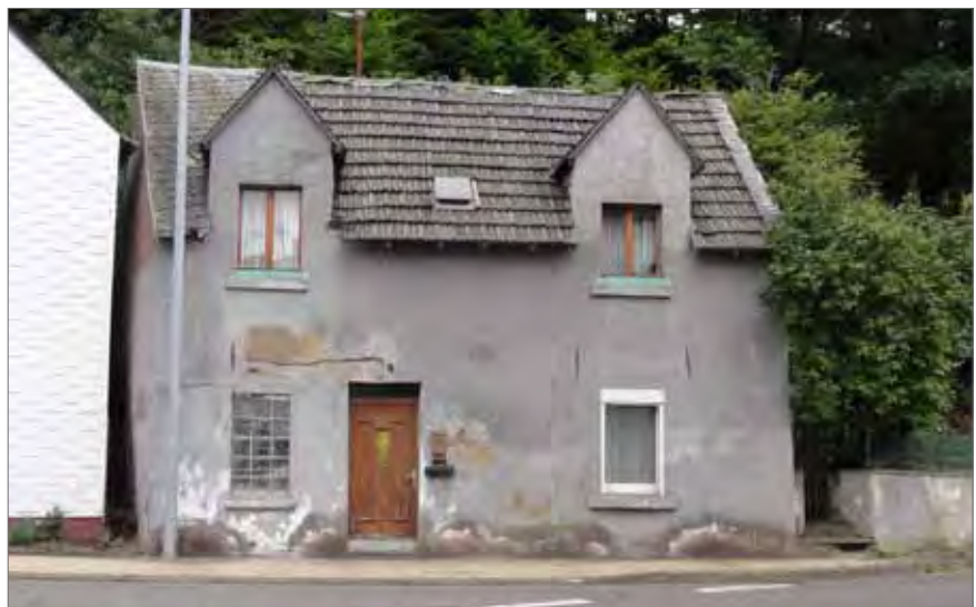
Abb. 161: Bausubstanzielle Mängel, Bsp. Ortskern Urmersbach Foto: Kernplan
