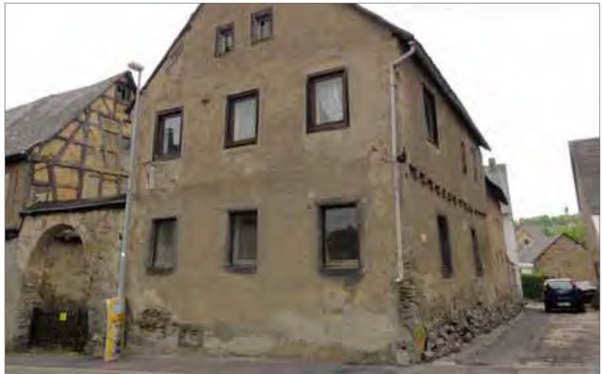
Abb. 148: Leerstand und Wohnumfelddefizite Koblenzer Straße Kaisersesch Foto: Kernplan
